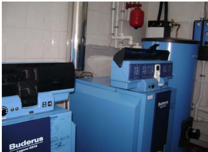
Отопительные котлы конструктивно одинаковы, различаются только контроллерами, установленными на их корпусе и, соответственно, функционалом: слева — «ведомый», справа — «ведущий!»
