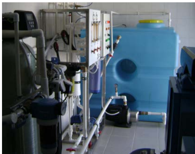
Справа, на переднем плане, снова виден «ведомый» котёл с приставной дизельной горелкой, напротив него — комплекс системы водоподготовки, а у дальней стены — бак для накопления чистой воды
