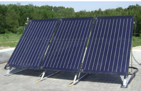
Панели солнечных коллекторов, установленные на плоской крыше с помощью соответствующего монтажного комплекта — металлических рам
