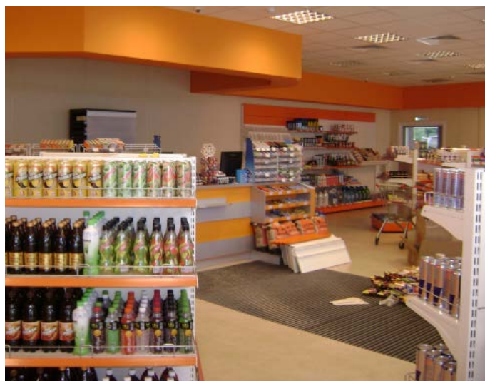
Торговый зал. На полу видна ниша в плитке, в которой уложено резиновое покрытие для сбора снега и мусора. Под этим покрытием находится один из контуров тёплого пола
