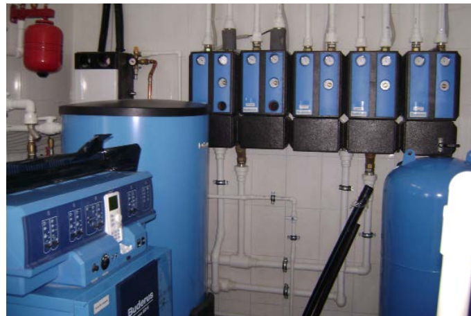
Цилиндрический бойлер косвенного нагрева находится рядом с котлом, за ним виден монтажный комплект (в белом корпусе), «ответственный» за работу геолоконтура. На стене установлены пять модулей отопительных контуров — по два на системы отопления и тепловые завесы и один на вентиляцию. Синий бак справа относится к системе водоподготовки
